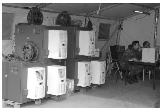
„Serverraum“ eines Gefechtsstandes
