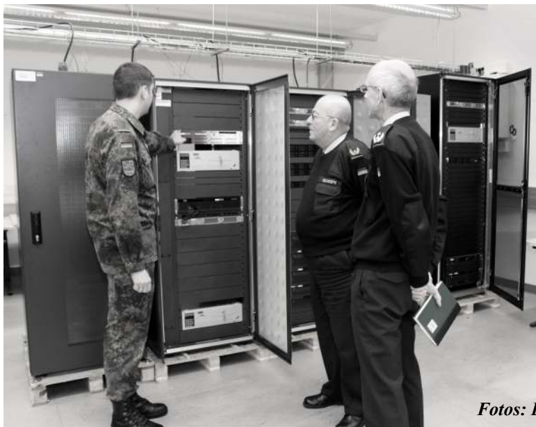
Übergabe der Anlage durch Oberstleutnant Rösner (r.) an Brigadegeneral Schoepe (m.)
