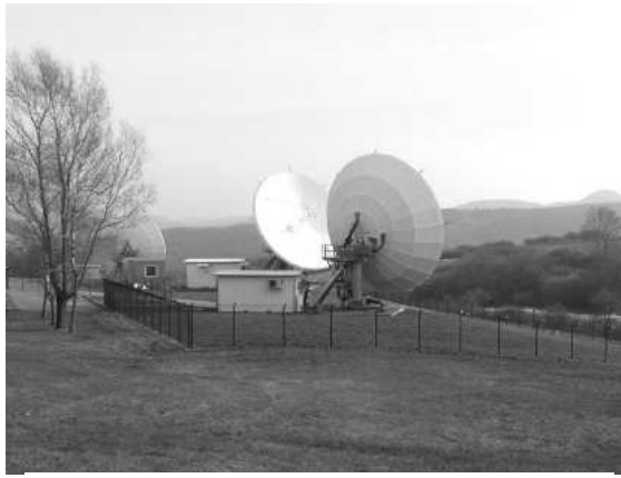
Die Bodenstation bei Gerolstein ist Teil des satellitengestützten Kommunikationssystems der Bundeswehr (SATCOMBw). Es ermöglicht weltweit abhörsichere Telefongespräche und Videokonferenzen
