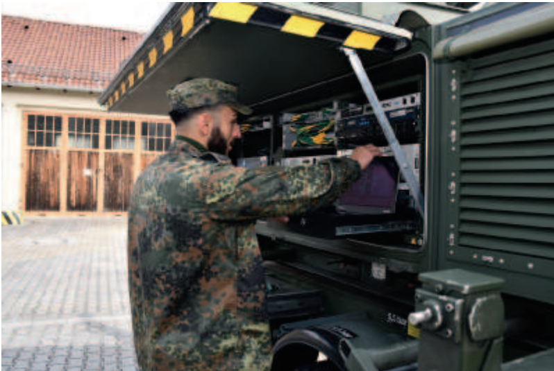
Drei Anlagen an drei Standorten - In Murnau, Villach und Murain stehen die Satellitenanlagen des IT-Bataillons; Foto: Bundeswehr/Jenny Henning
